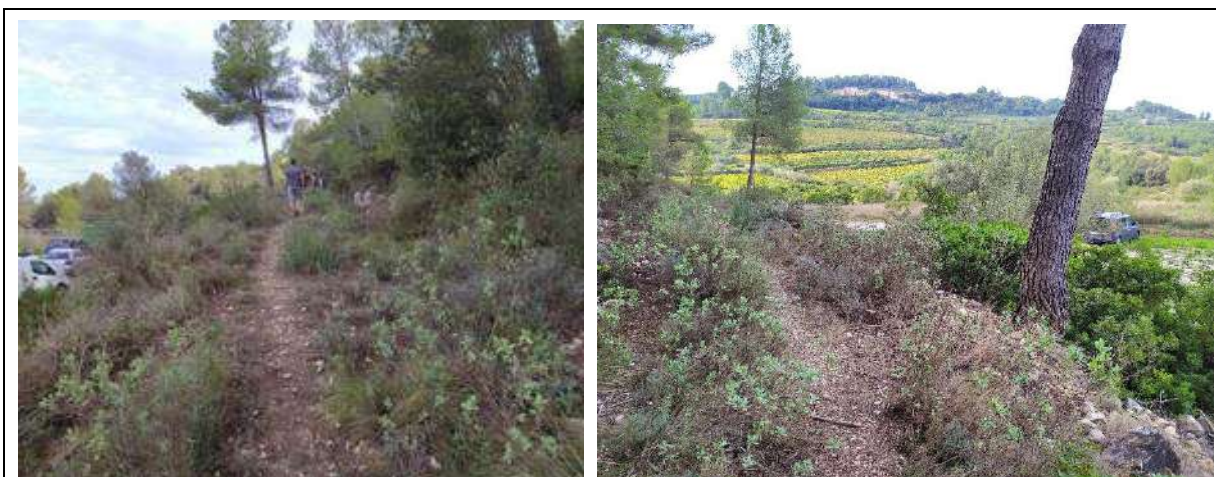
Estat actual del camí de desembosc abandonat.
